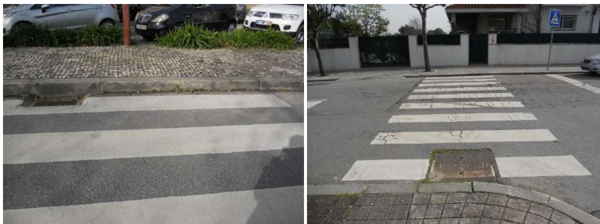
Figura 69. Inexistência de rebaixamentos de acesso a passeadeira, ou a sua incorreta execução
