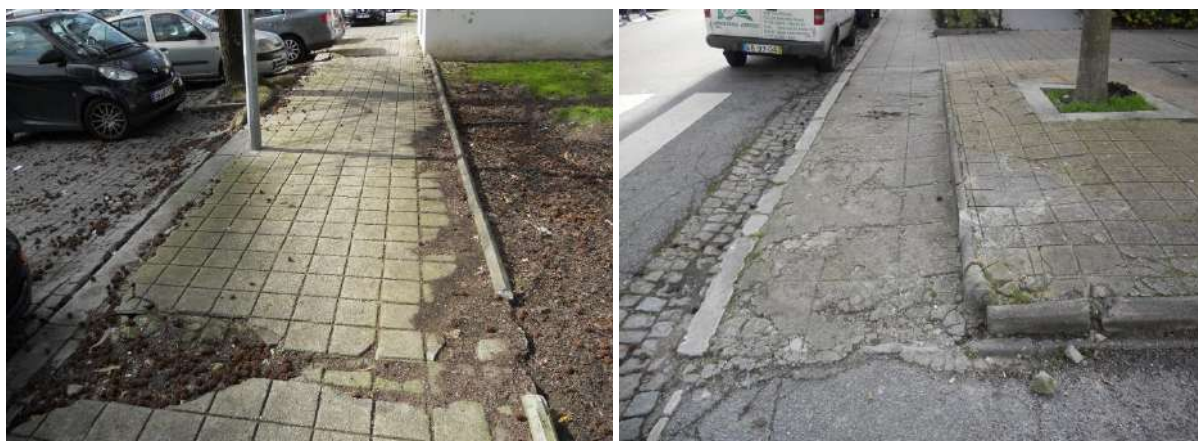
Figura 148. Tipologia de pavimentos e falta de manutenção
