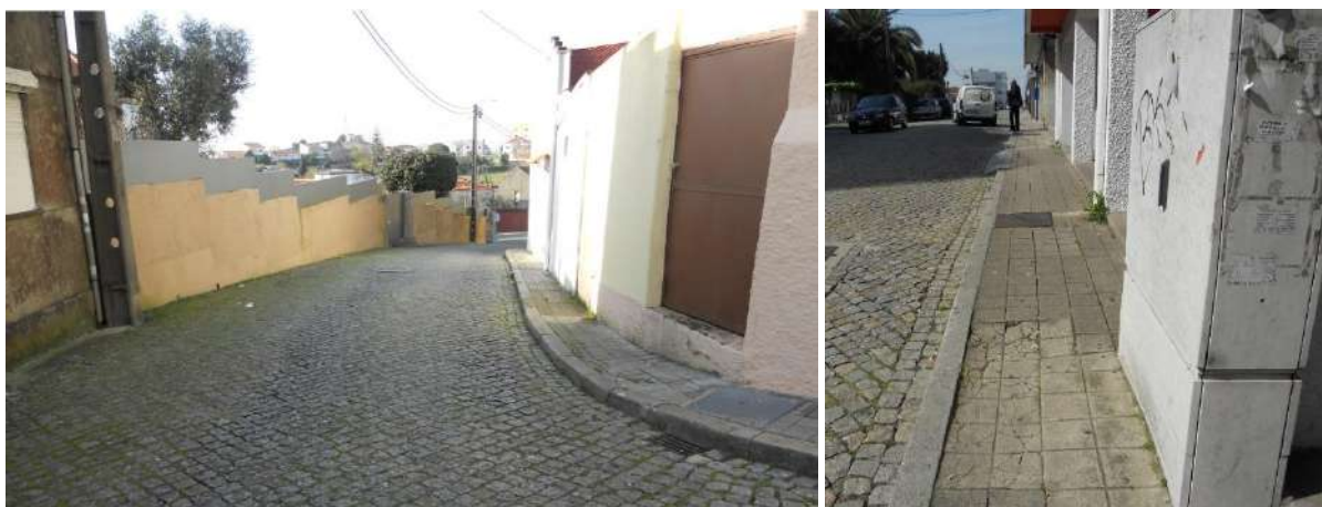
Figura 146. Passeios subdimensionados e descontínuos (esquerda) e barreiras arquitetónicas e urbanísticas
