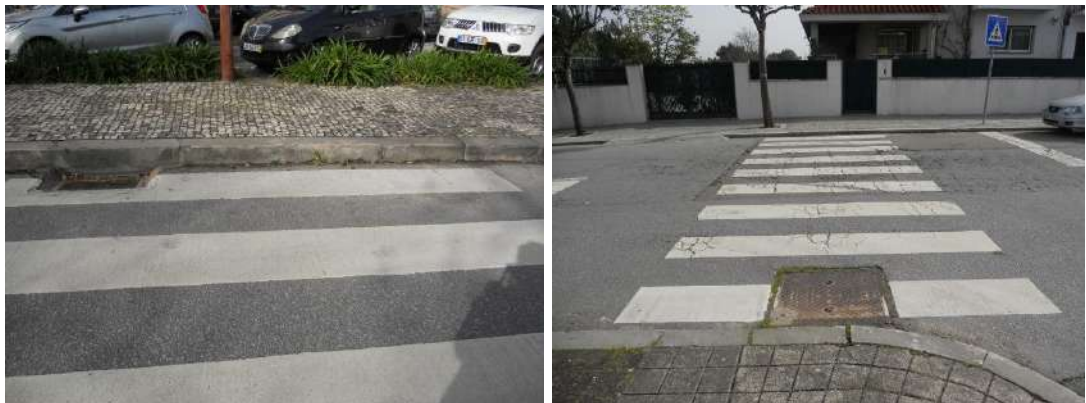
Figura 54. Inexistência de rebaixamentos de acesso a passeadeira, ou a sua incorreta execução
