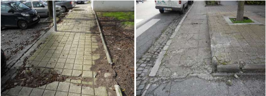
Figura 158. Tipologia de pavimentos e falta de manutenção
