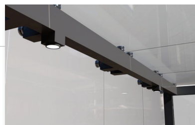
iluminação LED noturna
