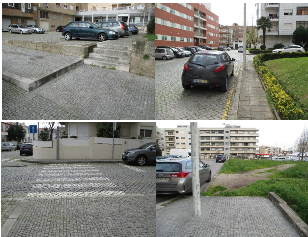
Figura 14. Exemplos de barreiras arquitetónicas e urbanísticas à acessibilidade universal no concelho da Maia (2020)
